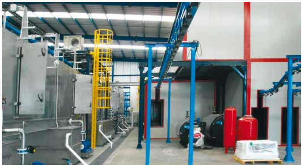
12 – Los hornos (de secado de la fase de pretratamiento, al centro; de polimerización “canopy”, a la derecha).
