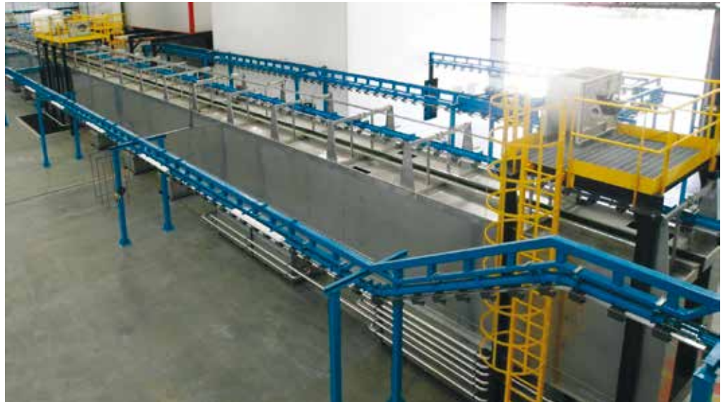
11 – El túnel de pretratamiento de la línea de Celaya.
