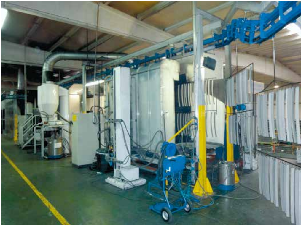
9 – La zona de aplicación de la línea en polvo instalada en Vigo.
